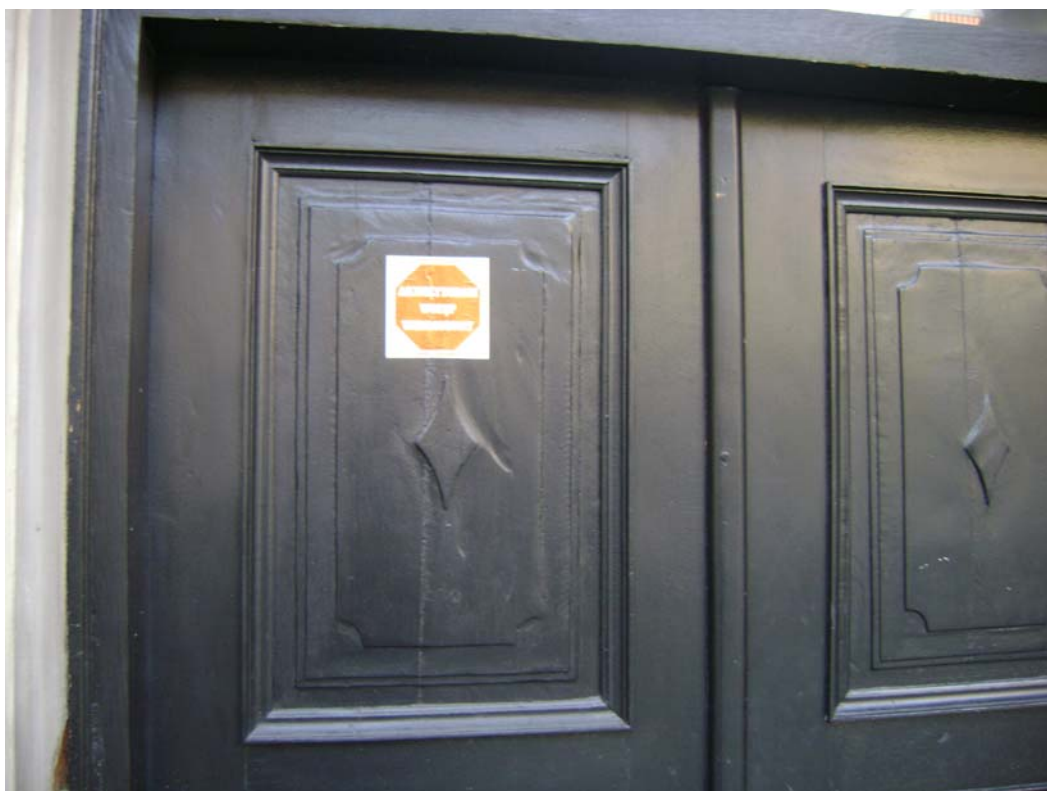
Widoczne nierówności powierzchni płycin – efekt oczyszczani powierzchni szlifierką oscylacyjną!
